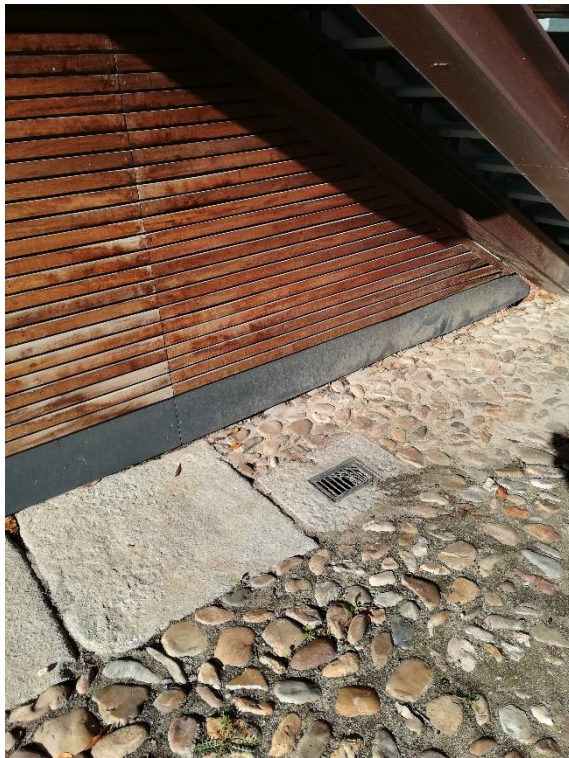
18.- REVESTIMIENTO DE LISTONES DE MADERA DE NAVE/LEÑERA DETERIORADO POR EFECTOS CLIMATOLÓGICOS: AGUA, SOL,...
