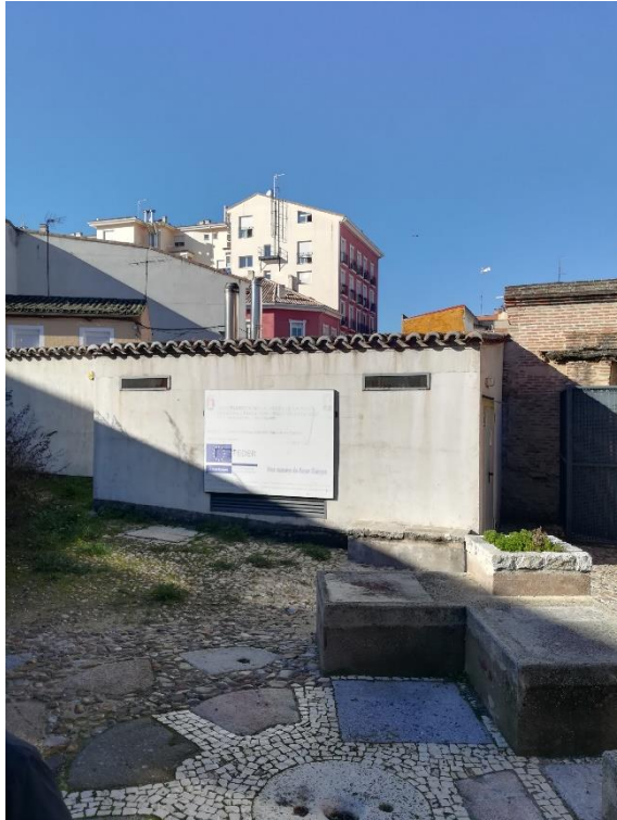
25.- PARAMENTOS A REPARAR DE CASETA DE INSTALACIONES Y ESPACIOS LIBRES CON PRESENCIA DE VEGETACIÓN PARASITA A ELIMINAR
