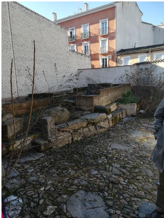
26.- ESPACIOS LIBRES CON PRESENCIA DE VEGETACIÓN PARSITA ESPONTANEA A ELIMINAR, COMPLETAR FALTAS DE PAVIMENTO Y MEDIANERAS A REVESTIR/PROTEGER
