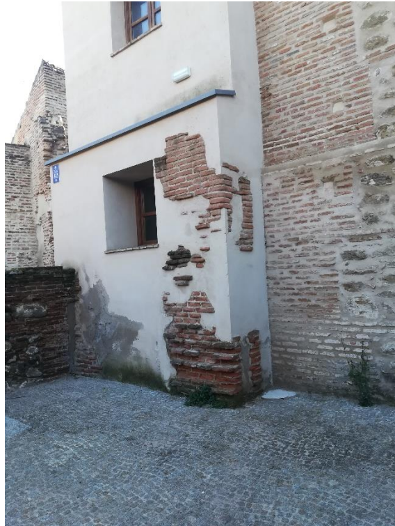
16.- REVOCOS DESPRENDIDOS Y LADRILLOS METEORIZADOS POR EFECTO DE AGUAS DE LLUVIA, CAPILARIDAD Y SALPIQUE
