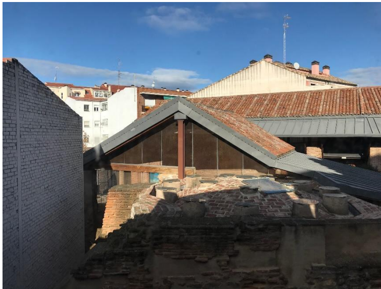
22.- CUBIERTA DE HORNOS/COBERTIZO Y MALLAS DE HIERRO CON PRESENCIA DE ÓXIDO Y PEQUEÑAS FALTAS Y MEDIANERAS A REVESTIR/PROTEGER
