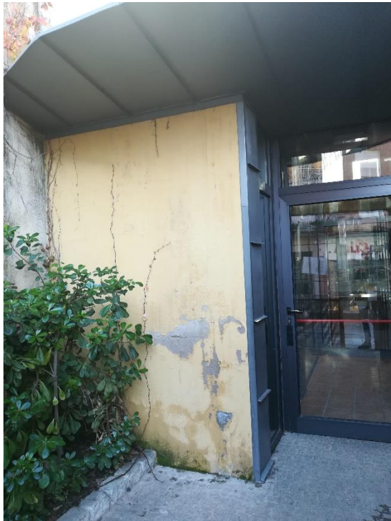
3.- VEGETACIÓN A ELIMINAR EN ACCESO A BIBLIOTECA PARA ELIMINAR HUMEDADES POR CAPILARIDAD EN MUROS. PARAMENTO A REPARAR/ REVESTIR Y EN SU CASO AISLAR TÉRMICAMENTE
