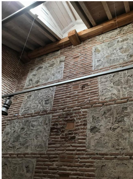
12.- FILTRACIONES DE AGUA A TRAVÉS DE TRONERAS DE LA IGLESIA
