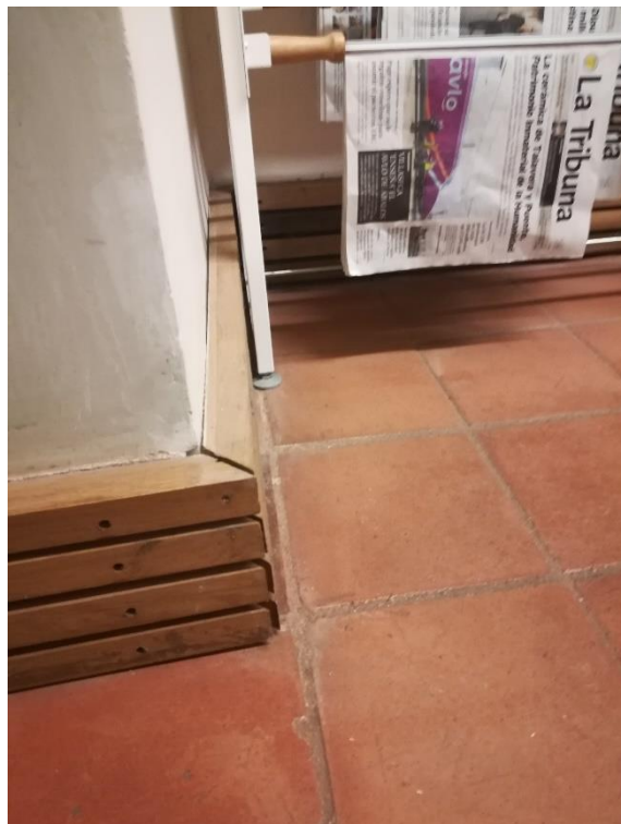
6.- ZONAS DE RODAPIÉ AFECTADAS POR HUMEDAD Y DESPRENDIDOS DE PARAMENTOS VERTICALES
