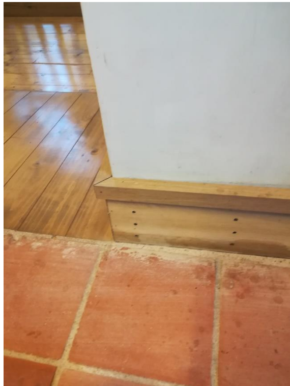
8.- ZONAS DE RODAPIÉ AFECTADAS POR HUMEDAD POR EFECTO DE LIMPIEZA
