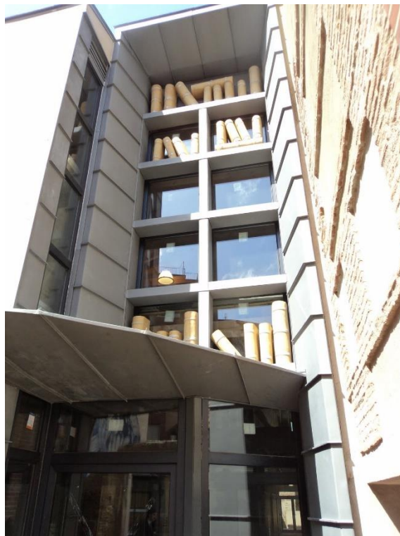
2.- ACCESO PRINCIPAL A BIBLIOTECA. PARAMENTO LATERAL (CAJA DEL ASCENSOR) A SELLAR Y AISLAR TÉRMICAMENTE
