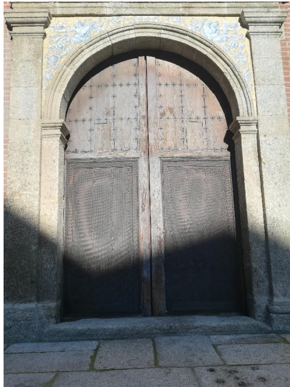
1.- PORTADA DE MADERA HISTÓRICA CON DAÑOS SUPERFICIALES POR EFECTOS DEL AGUA, SOL (UV, IR),...
