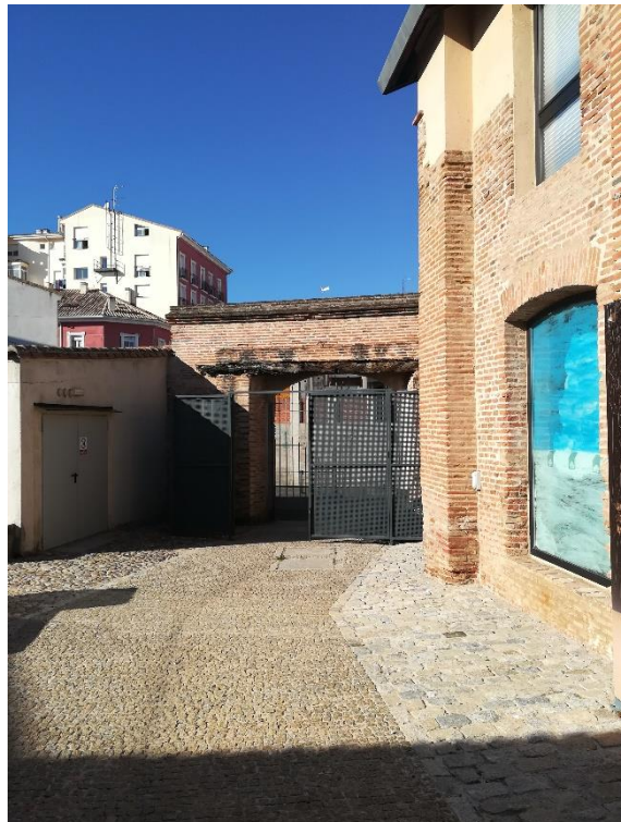
24.- ACCESO C/PADRE SALMERÓN. CARGADERO DE MADERA DAÑADO A SUSTITUIR Y PROTEGER CON BABERO DE ZINC
