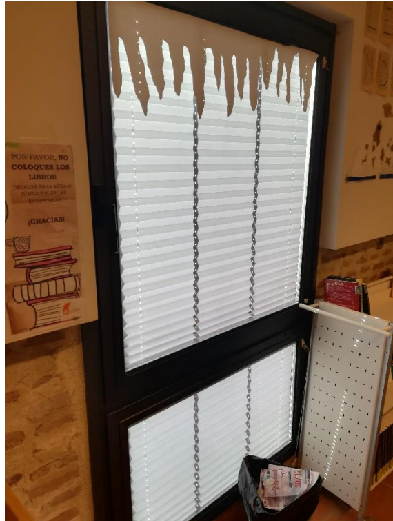
19.- CARPINTERÍAS DE ALUMINIO CON CORTINILLA ENTRE VIDRIOS A REPARAR/AJUSTAR CIERRE, A CAMBIAR TIRADORES, Y REVISAR CORTINILLAS
