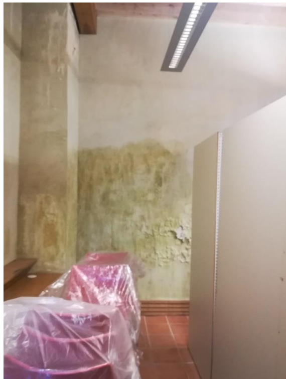
10.- DAÑOS EN PARAMENTOS INTERIORES DE LA IGLESIA POR HUMEDAD DE CAPILARIDAD Y FILTRACIONES DE PARCELA COLINDANTE (IDEM ANTERIOR)
