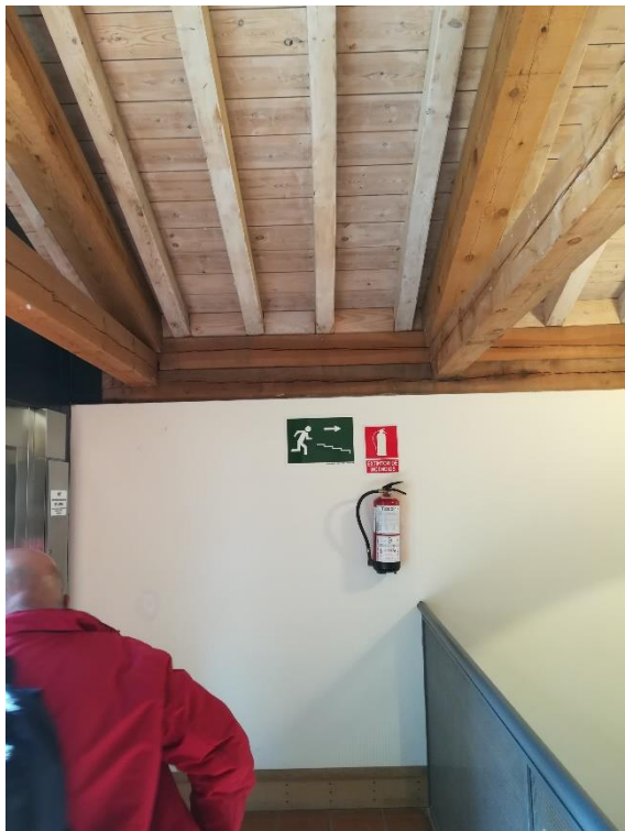
14.- CARRERA DE MADERA AFECTADA POR FILTRACIONES DE AGUA DE LA CUBIERTA DE LA IGLESIA (ID.ID).
