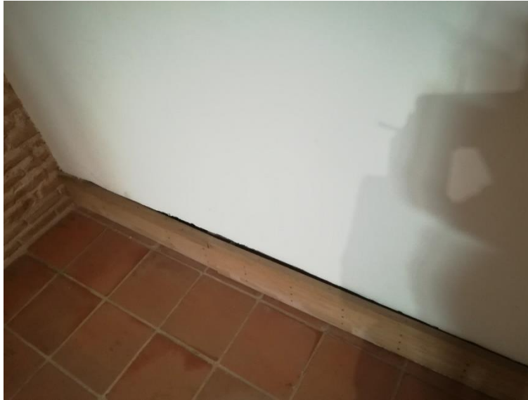
15.- RODAPIÉ DESPRENDIDO DE PARAMENTOS VERTICALES
