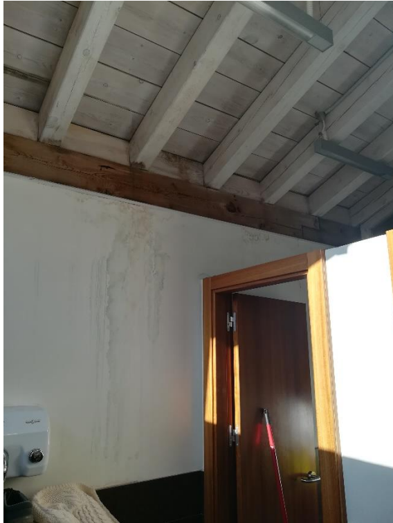
13.- CARRERA DE MADERA Y PARAMENTOS VERTICALES AFECTADOS POR FILTRACIONES DE AGUA DE LA CUBIERTA DE LA IGLESIA (PLANTA ALTA, LADO OESTE)
