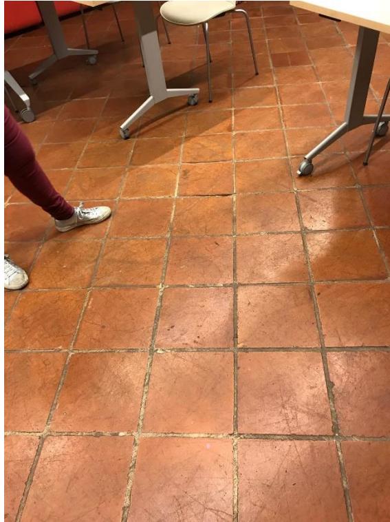
7.- DAÑOS EN PAVIMENTO DE BARRO COCIDO A REPARAR
