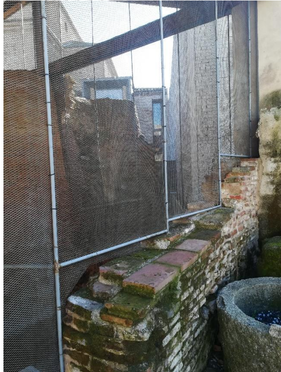
23.- MALLA DE HIERRO DE ZONA HORNOS/COBERTIZO CON PRESENCIA DE ÓXIDO Y PEQUEÑAS FALTAS
