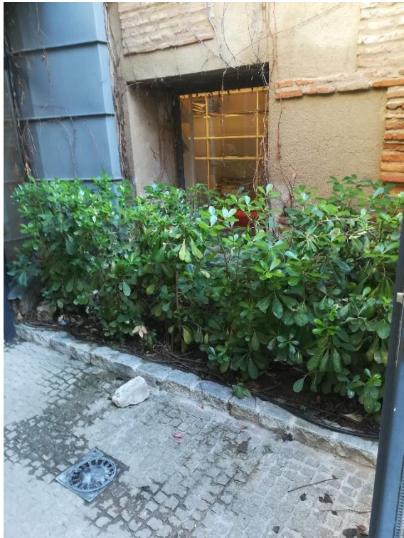
4.- VEGETACIÓN Y JARDINERAS EN TERRENO A ELIMINAR EN ACCESO A BIBLIOTECA PARA ELIMINAR HUMEDADES POR CAPILARIDAD EN MUROS. (NUEVAS JARDINERAS PREFABRICADAS Y EXENTAS).
