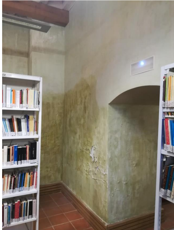
9.- DAÑOS EN PARAMENTOS INTERIORES DE LA IGLESIA POR HUMEDAD DE CAPILARIDAD Y FILTRACIONES DE PARCELA COLINDANTE (INTERIOR LADO ESTE)
