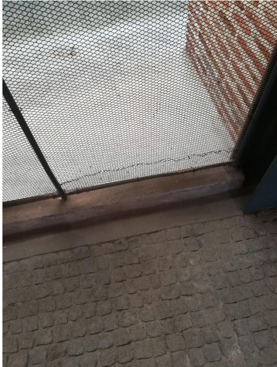
17.- CERRAMIENTO DE MALLA METÁLICA EN NAVE/LEÑERA A REPARAR/COMPLETAR
