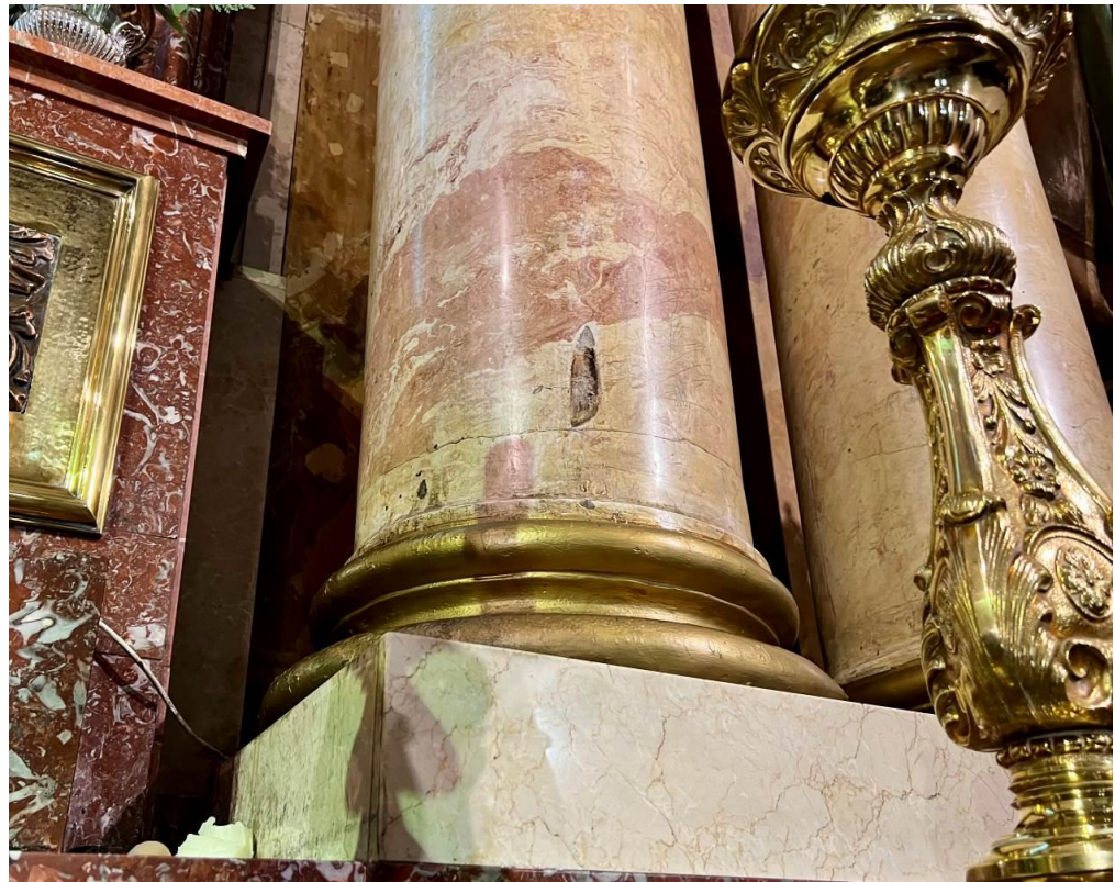
Deterioros en las columnas: pérdidas y fisuras.
