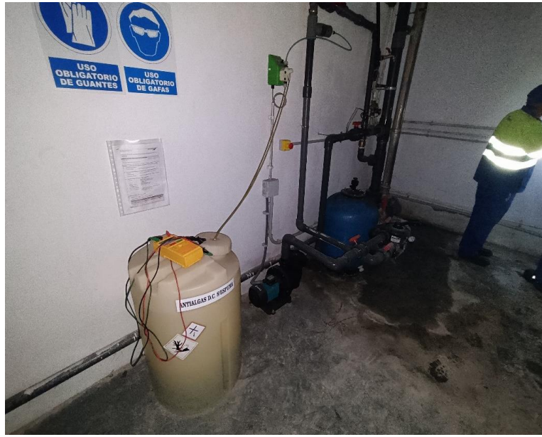
3.5 VISTA 2 DE SALA DE EQUIPOS E INSTALACIONES
