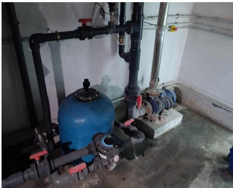
3.4 VISTA 1 DE SALA DE EQUIPOS E INSTALACIONES
