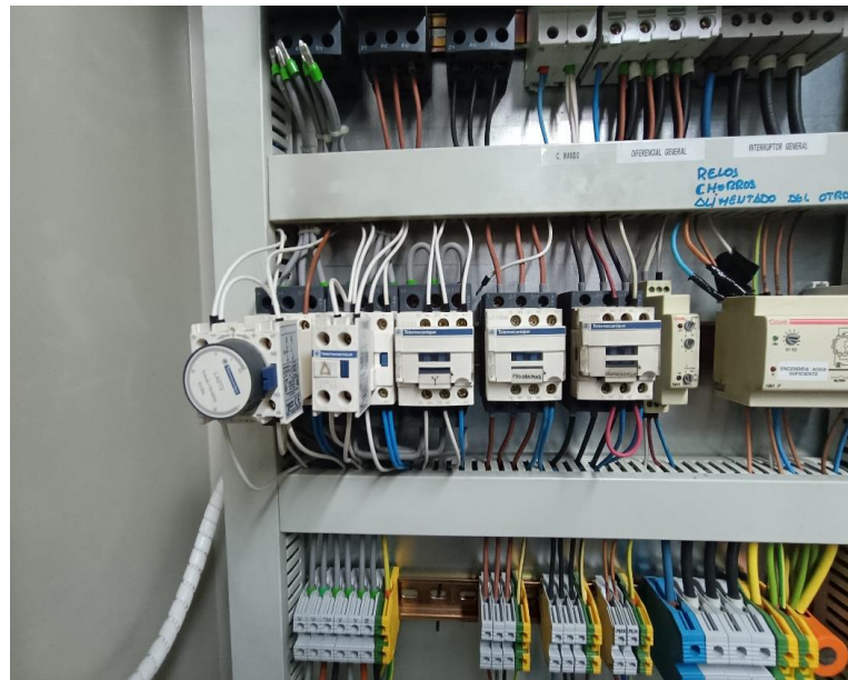
2.4 CUADRO DE PROTECCIÓN Y CONTROL
