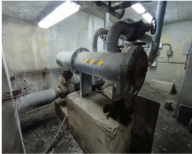
2.3 VISTA 2 DE SALA DE EQUIPOS E INSTALACIONES
