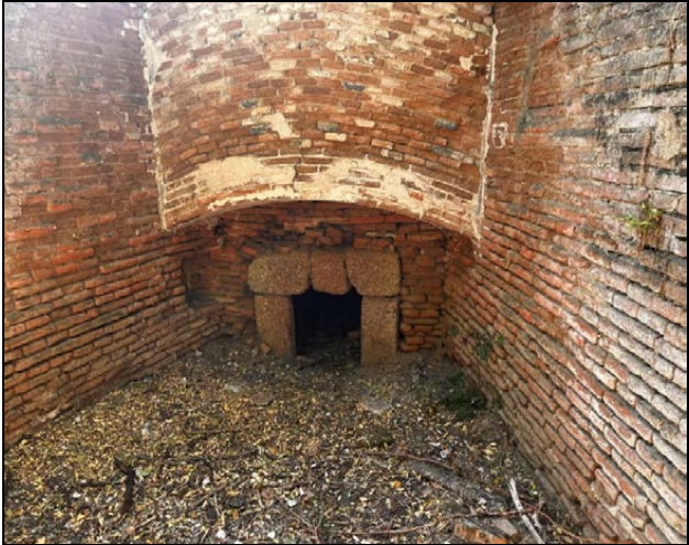
FOTOGRAFÍA 08. BOCA CÁMARA COMBUSTIÓN
