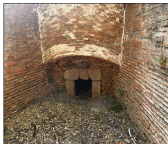
FOTO 6. Acceso a la cámara de combustión
