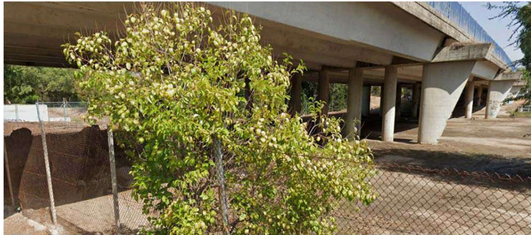
Zona de aparcamiento encharcada bajo la estructura de la N-502
