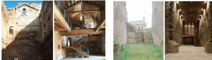
Comparativas fotografías antes- después intervención en el castillo de los Templarios de Ponferrada. F. Cobos estudio arquitectura
