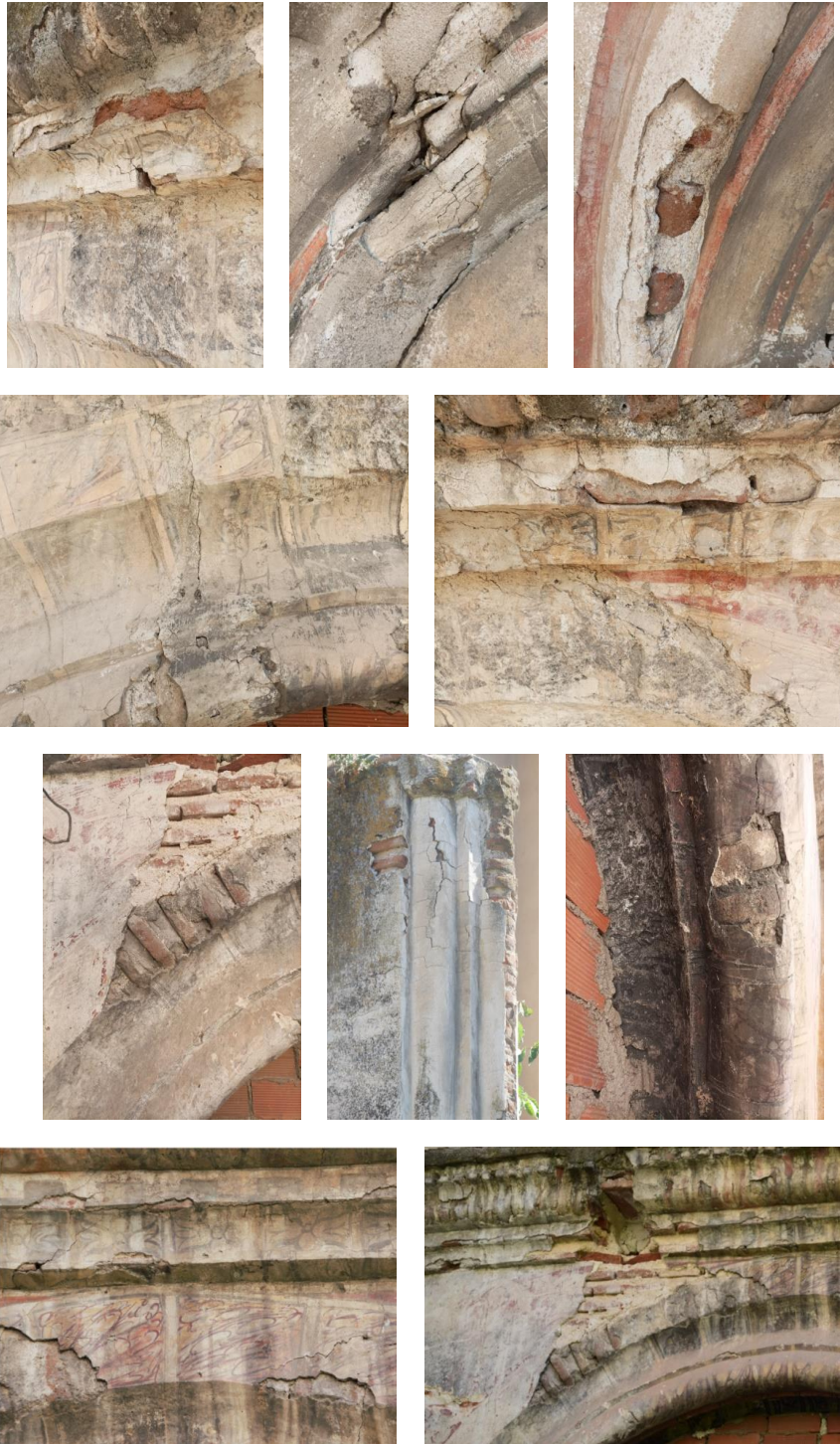
Fig. 116-139. Fisuras, grietas y oquedades en capa pictórica y llagueado.
