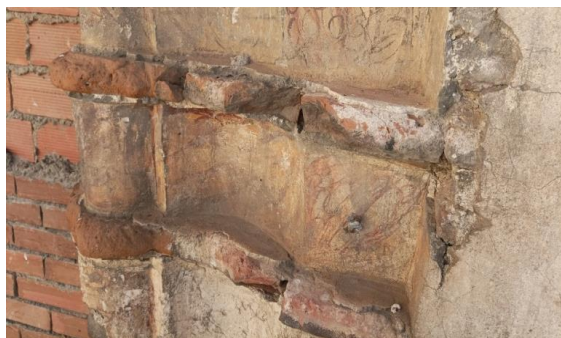
Fig. 110 y 111. Rotura en piezas de aparejo.
