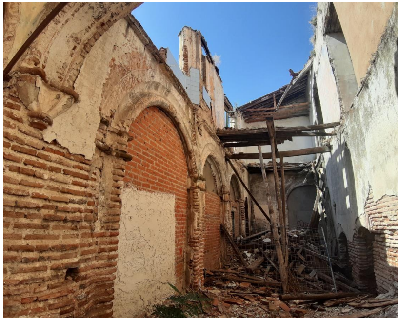
Fig. 23 y 24. Comparativa intradós de fachada Sur Octubre 2022 – Octubre 2023, ambas tras desprendimiento de vigas y cargadero de primera planta.
