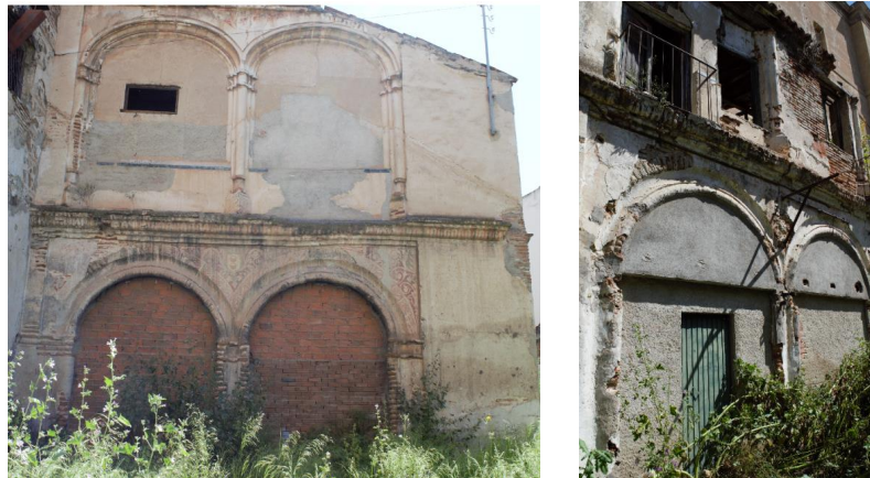
Fig. 6 y 7. Fachadas Oeste y Sur con restos de Pinturas Murales.
