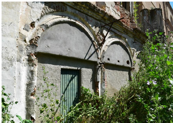
Fig. 83, 84 y 85. Panderos de cemento y abnegación de arcos en fachdas Oeste y Sur.
