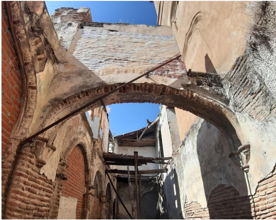
Fig. 27 y 28. Comparativa detalle arcada en interior de inmueble Octubre 2022 – Octubre 2023, ambas tras desprendimiento de entrevigado y cargadero de primera planta.
