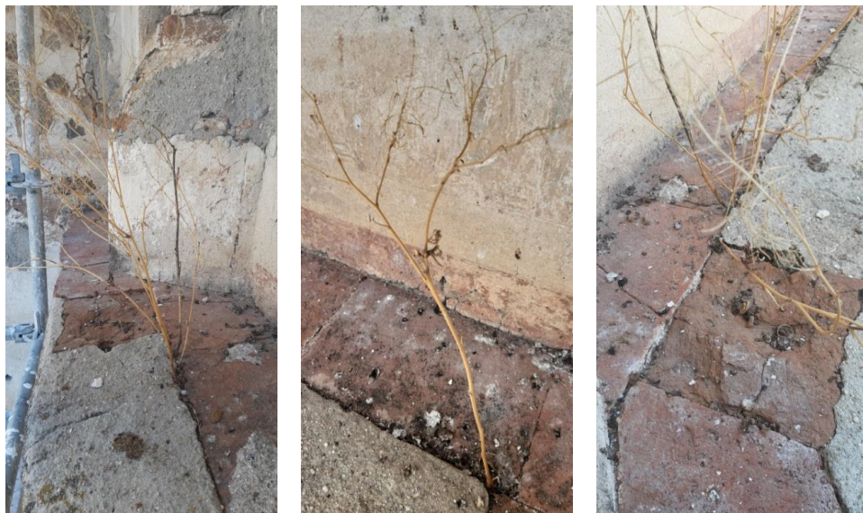
Fig. 31, 32 y 33. Enraizados en superficie de moldura y vierteaguas (alero).
