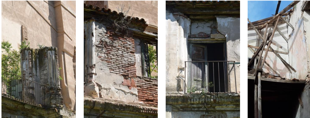
Fig. 112-115. Inestabilidad estructural de elementos constructivos.
