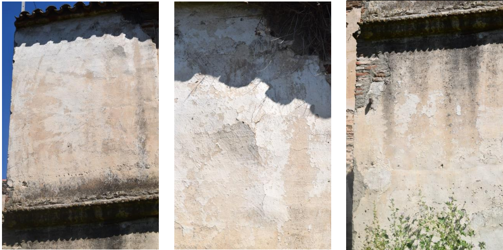
Fig. 43, 44 y 45. Acción de la humedad sobre paramento fingido de ladrillo. Degradación de materiales y abolsamiento de estratos.
