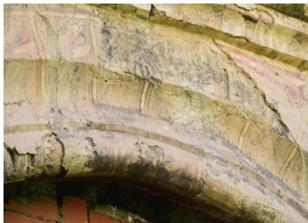
Fig. 158, 159 y 160. Eflorescencias o costras salinas.
