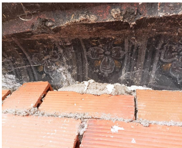
Fig. 82. Cemento y yeso de los muros de construcción lindando con zona interna de arcadas inferiores.
