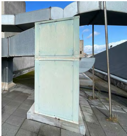
Fotos de bombas de calor actuales a desinstalar.
