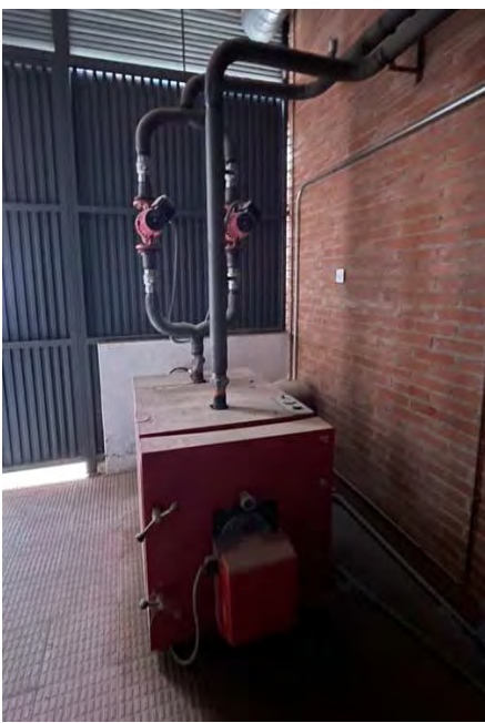
Foto: Caldera de gasoil a desinstalar.
